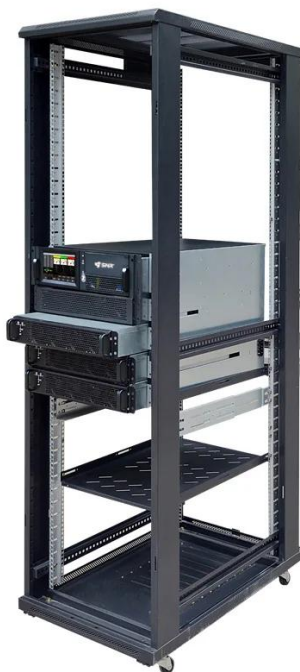
Рисунок 2 – ИБП в стойке
