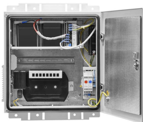
РИСУНОК 3 - ОБЩИЙ ВНУТРИ ШКАФА
