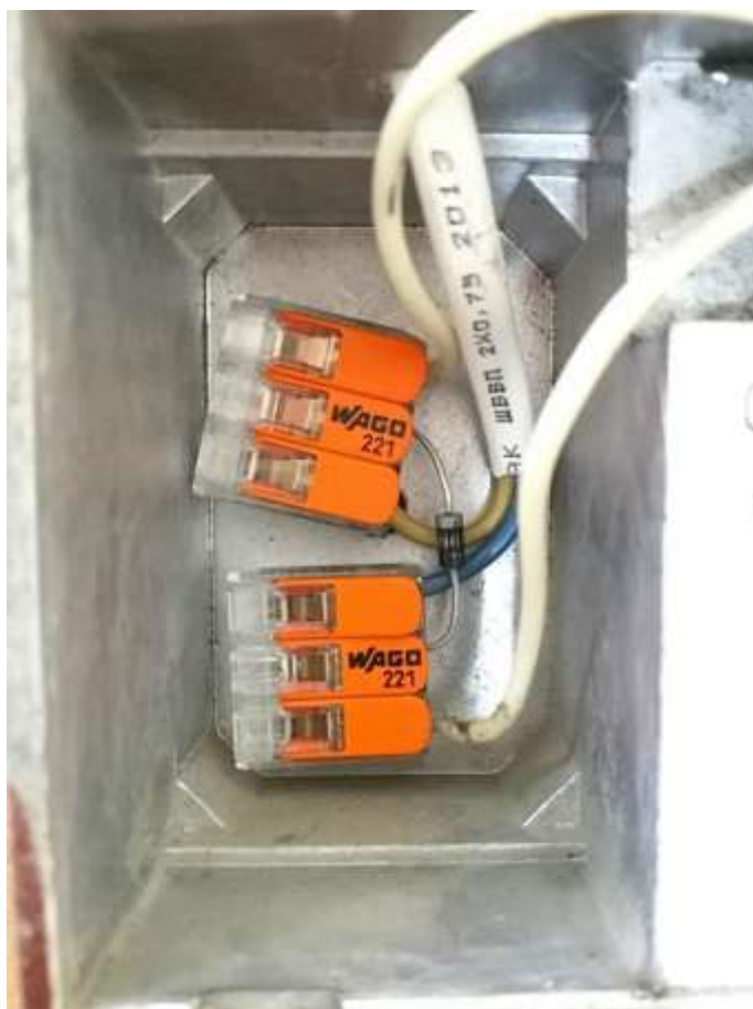
Рисунок 5 - Внешний вид подключения в монтажном отсеке замка
