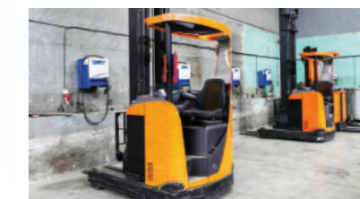
КОНТРОЛЬ ЗАРЯДА АККУМУЛЯТОРА
